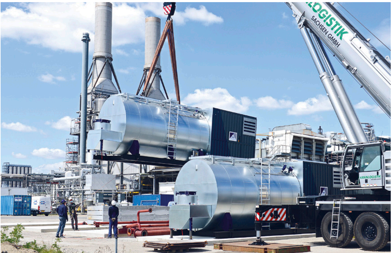
Um die die Energieversorgung des Standorts während der Umbauphase des GuD-Kraftwerks zu sichern, wurden Reservedampferzeuger installiert.
